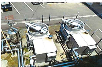
図3：学校の冷暖房の室外機
